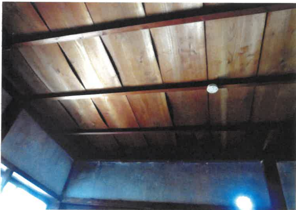
⑫ 屋内の状況（物件14建物納戸の天井の様子）
