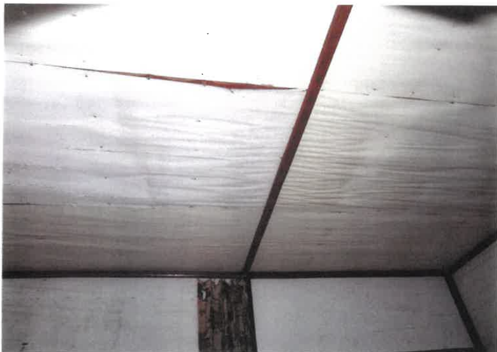
⑭ 屋内の状況（物件14附属建物符号2物置の天井の様子）
