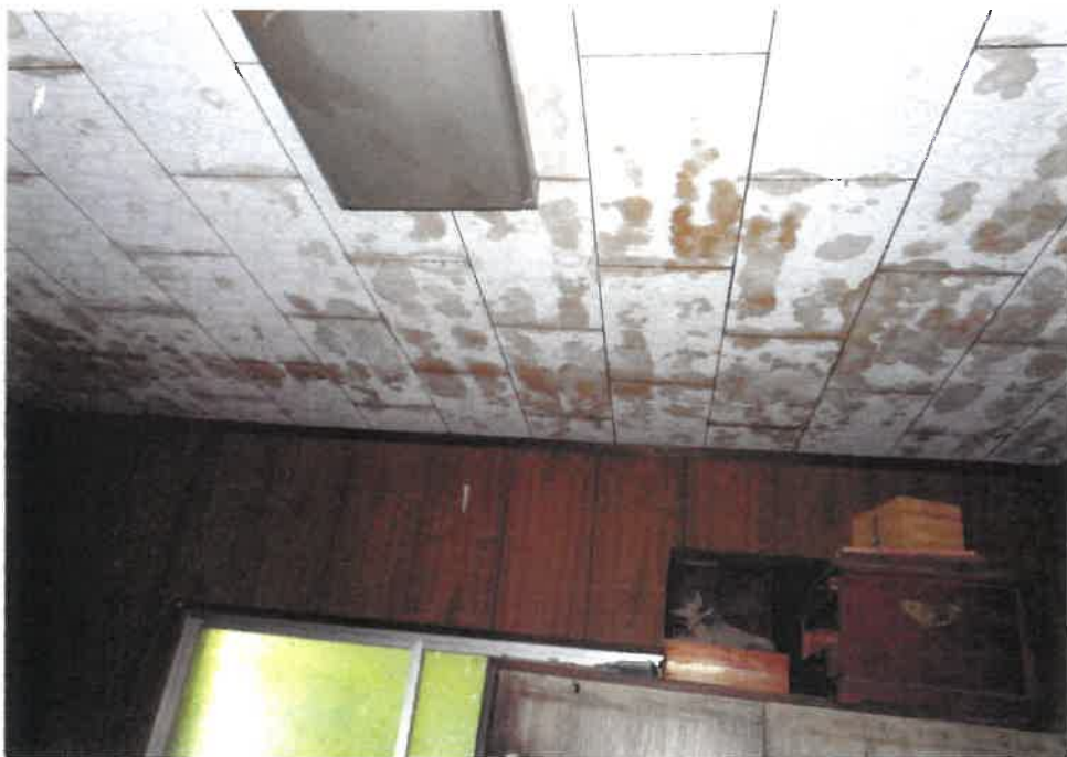
⑧ 屋内の状況（物件1 3建物洋室の天井の様子）
