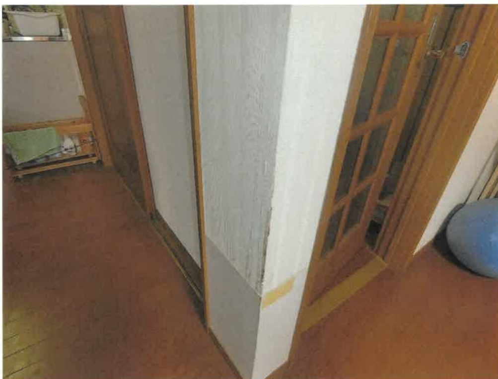
8 物件2主である建物内部の状況（クロスの損傷（リビング・ダイニング））
