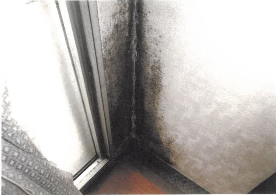
⑦ 洋室①カビの状況
