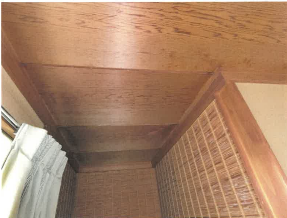
1 2 物件4建物内部の状況 (雨漏りによる天井の染み・広縁)
