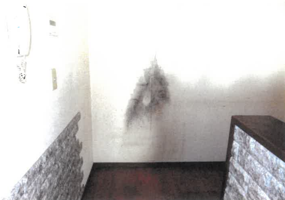
⑦ 屋内の状況（キッチンのクロスが黒くなっている様子）
