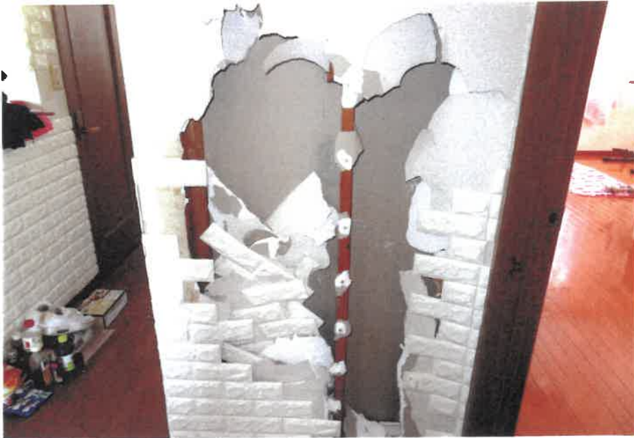
⑥ 屋内の状況（洋室3入口付近の壁の穴の様子）
