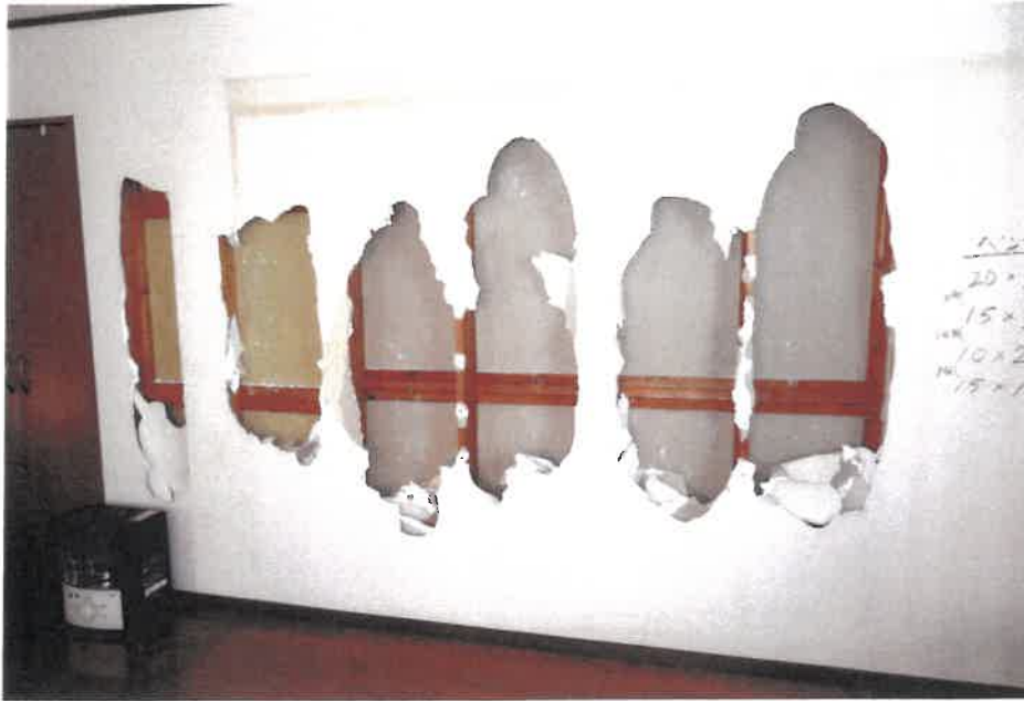
⑤ 屋内の状況（洋室3の壁に穴が開いている様子）
