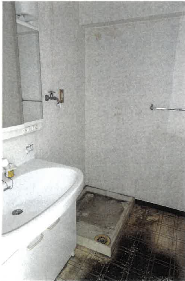
14 壁面・床面の汚損状況（洗面所（2-C号室））
