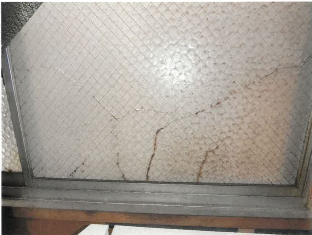
2 0 物件 3 附属建物 2 内部の状況（ガラス窓の損傷（ホール東側））
