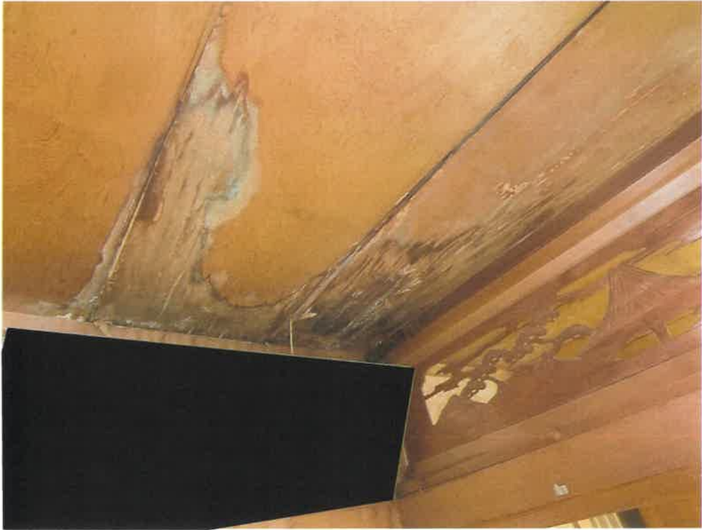
1 1 物件 3 主である建物内部の状況（雨漏りによる染み（和室 1））
