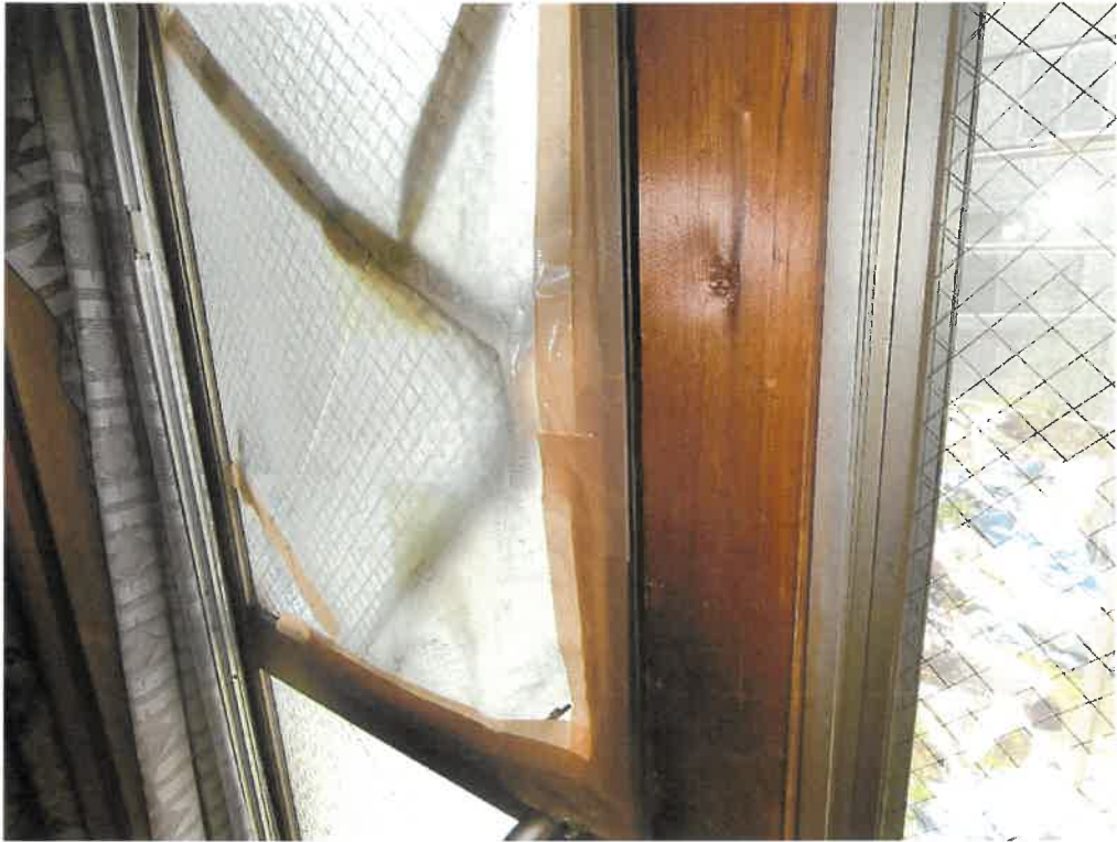
1 7 物件3主である建物内部の状況（ガラス窓の損傷②（2階南側））
