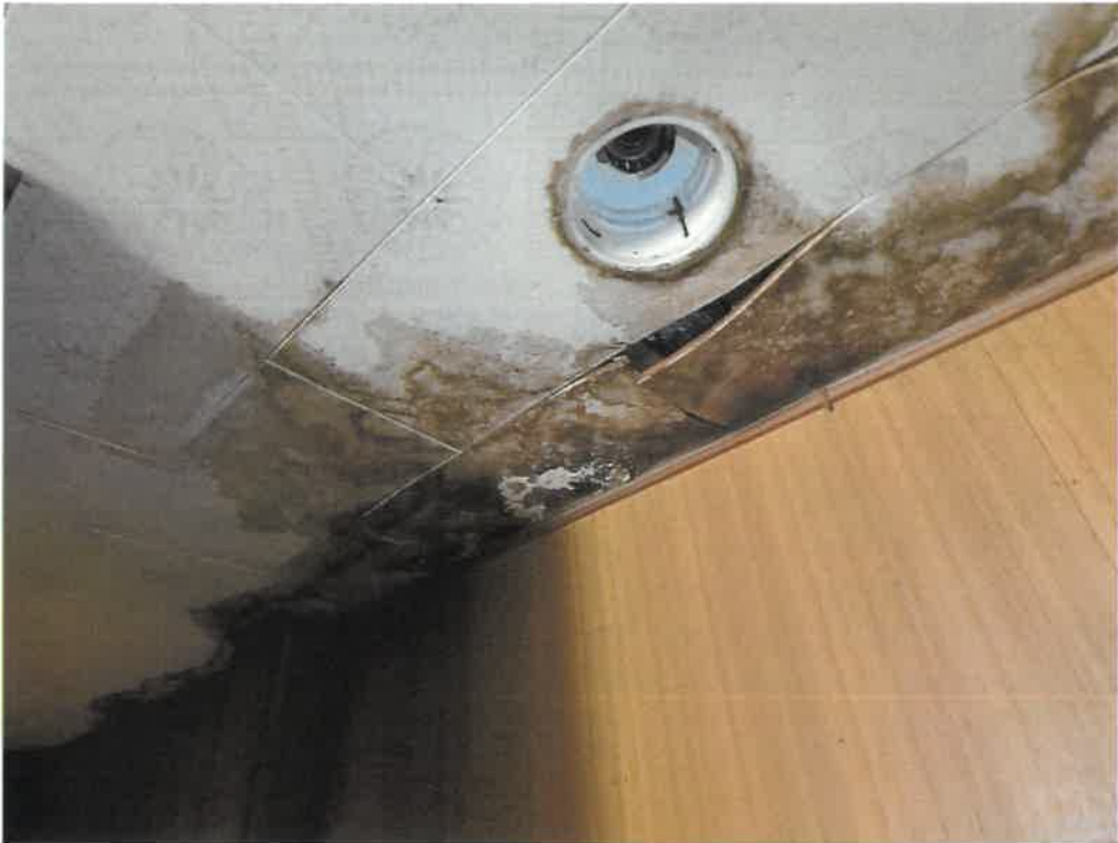
1 3 物件 3 主である建物内部の状況（雨漏りによる損傷（ホール））
