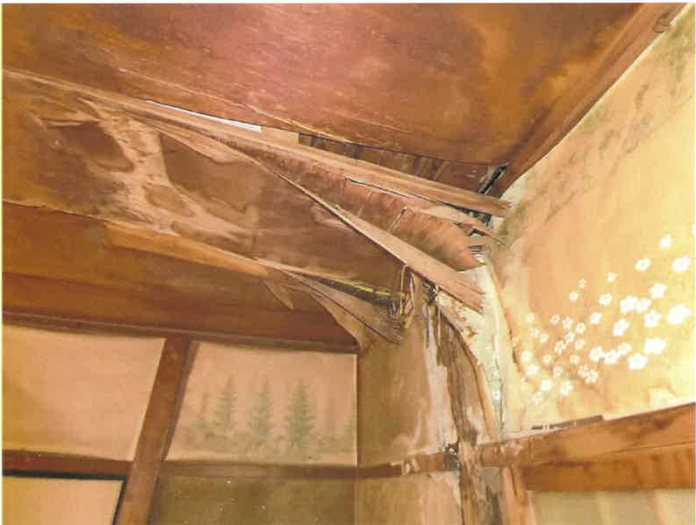
1 2 物件 3 主である建物内部の状況（雨漏りによる損傷（和室 3））
