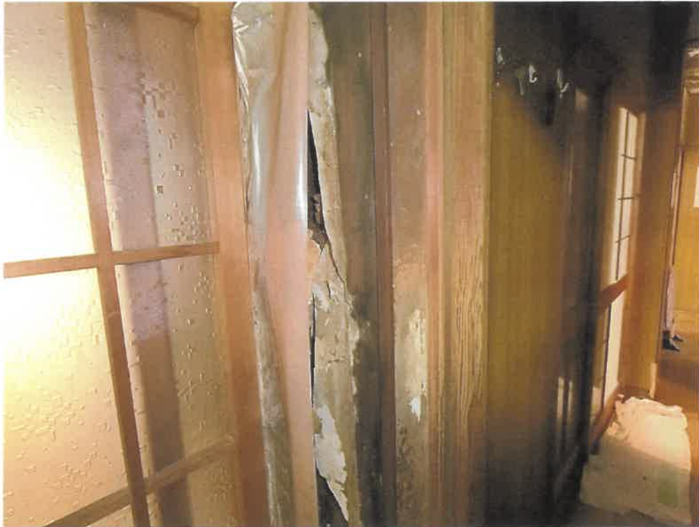
1 5 物件3主である建物内部の状況（雨漏りによる鉄骨柱化粧材の損傷（DK））
