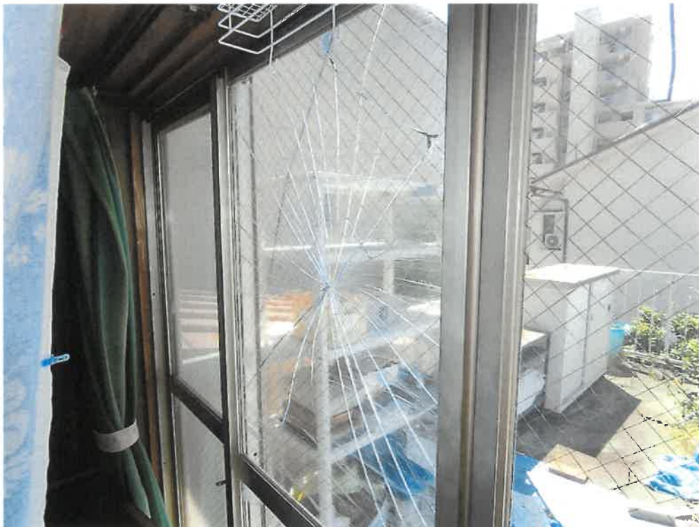
1 6 物件3主である建物内部の状況（ガラス窓の損傷①（2階南側））
