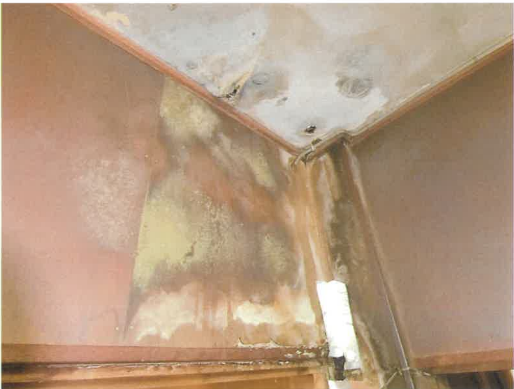
1 4 物件 3 主である建物内部の状況（雨漏りによる損傷（DK））
