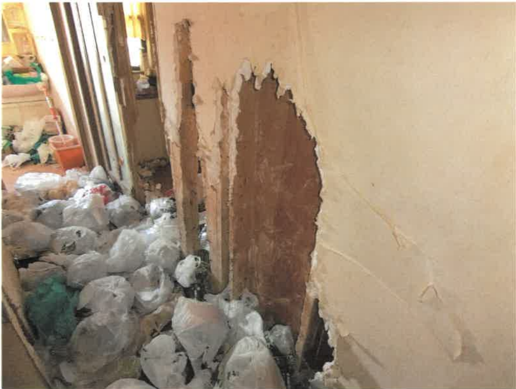
8 物件2建物内部の状況（壁面の損傷・LDK北東部）
