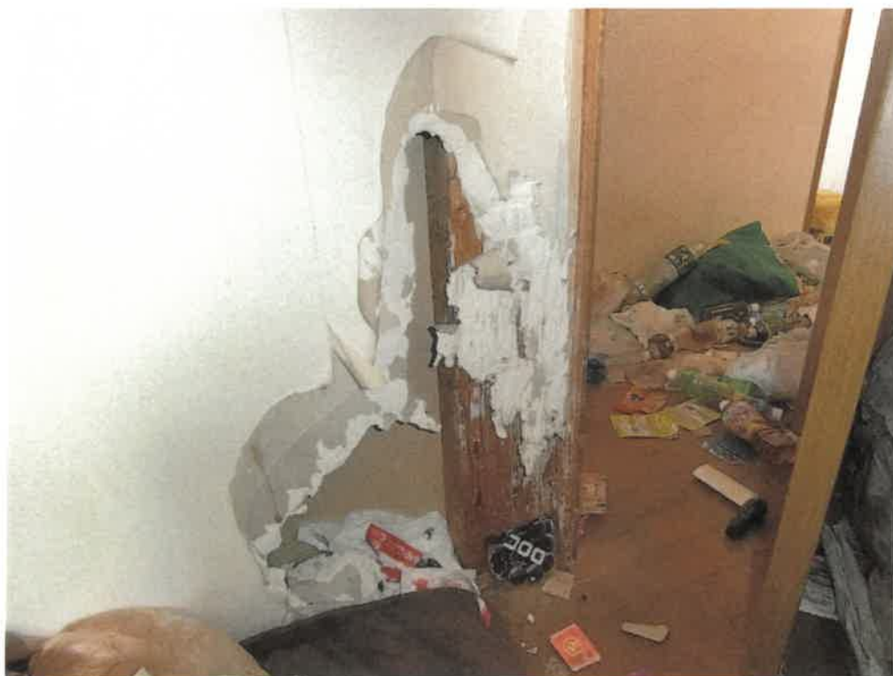
1 1 物件 2 建物内部の状況（壁面の損傷・洋室 2 南東部）
