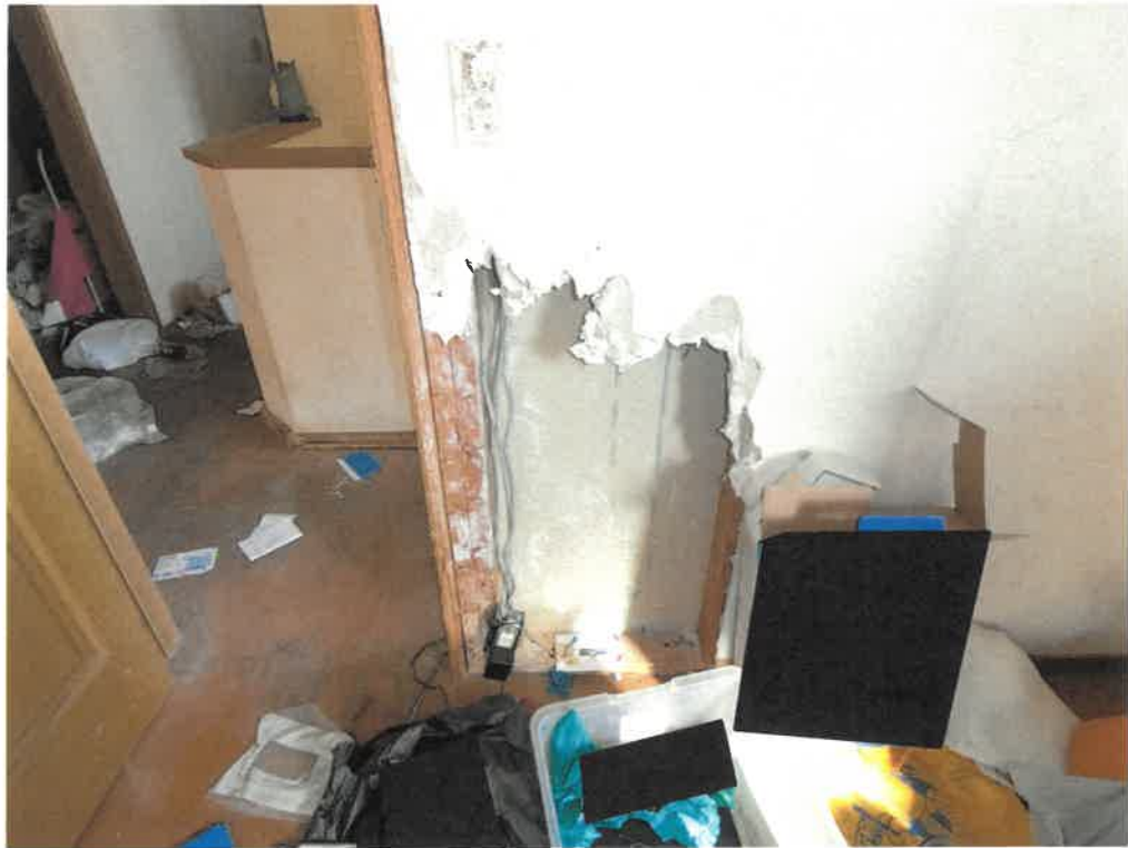
9 物件2建物内部の状況（壁面の損傷・洋室4北部）
