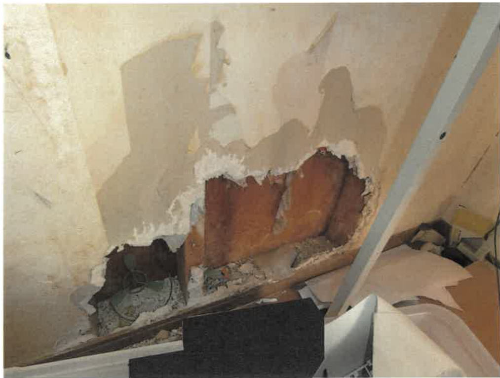
10 物件2建物内部の状況（壁面の損傷・洋室4南東部）
