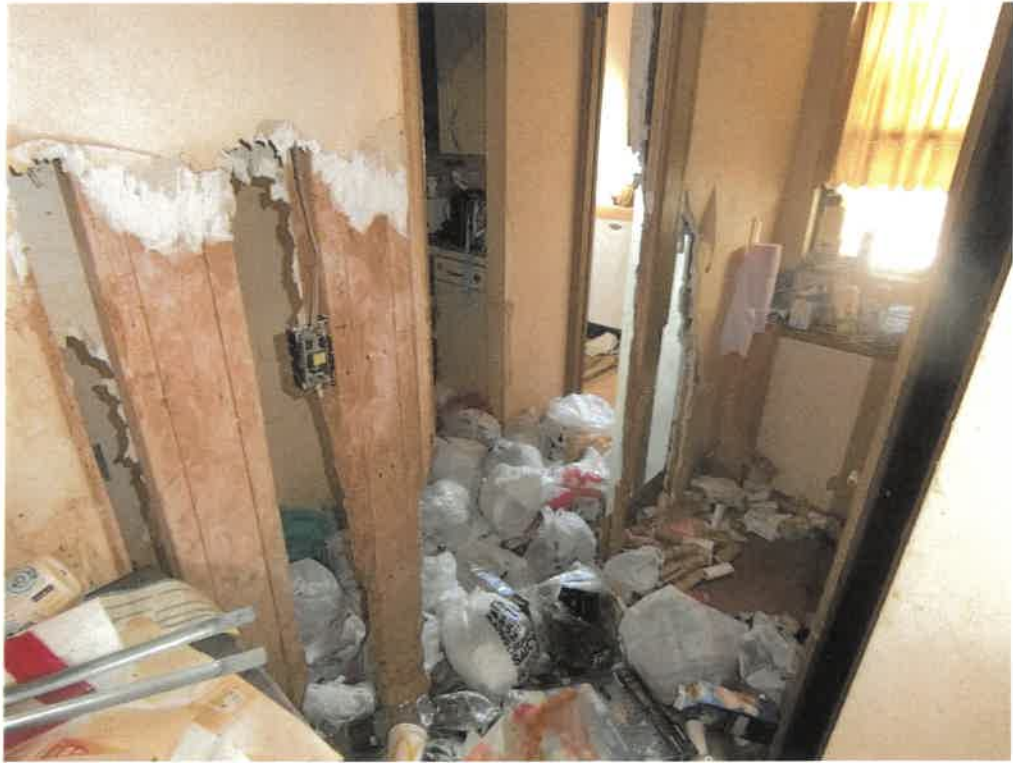
7 物件2建物内部の状況（壁面の損傷・ホール北部）
