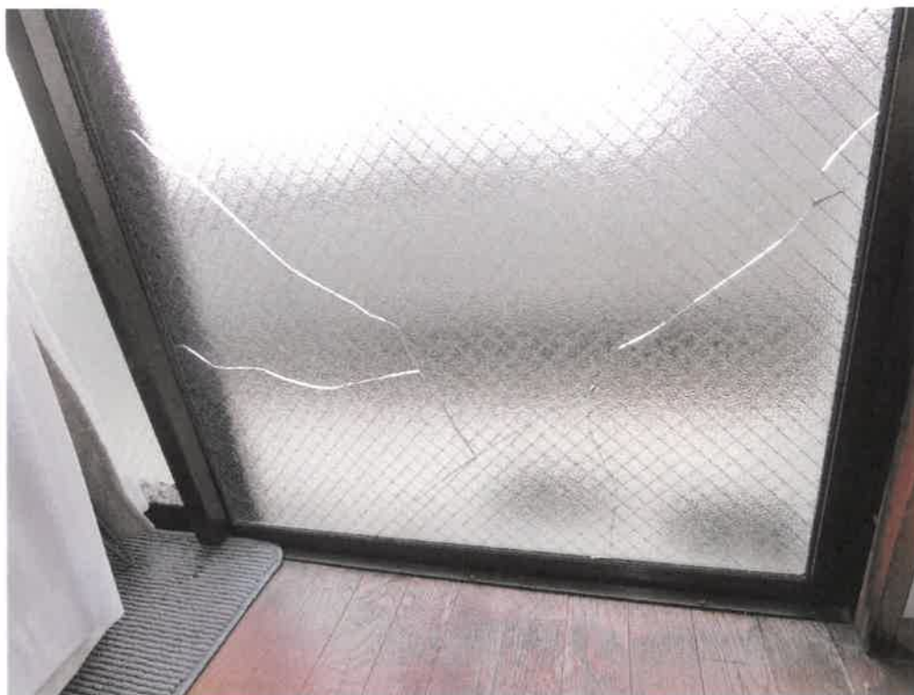
18 物件3建物内部の状況（S棟302号室・LDKの窓ガラス）
