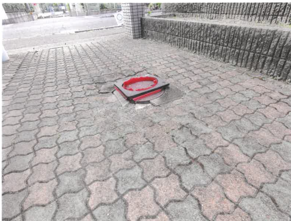
5 レンガ舗装の波打ち及び損傷（物件1 土地北部）
