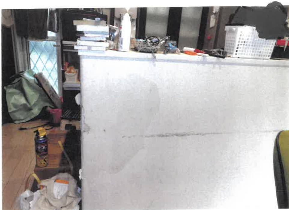
⑦ 屋内の状況（キッチンカウンターのクロスの汚れと剥がれの様子）
