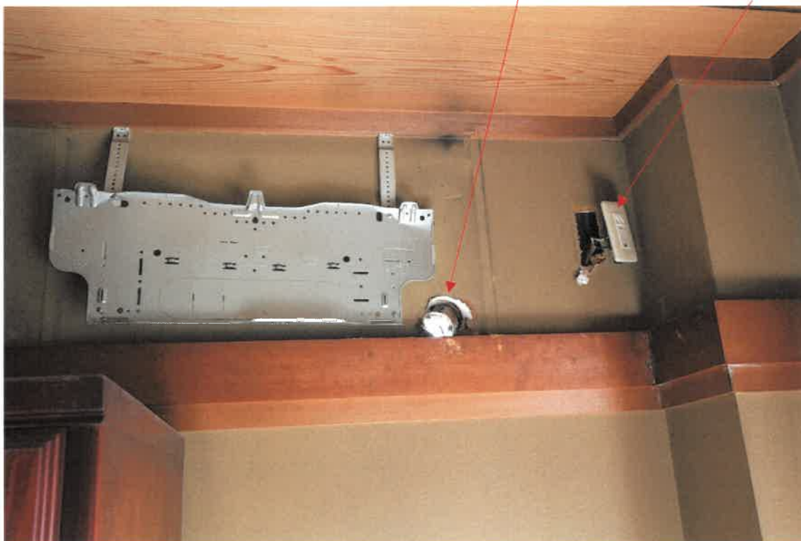
写真8 物件2建物2階室内(和室1, エアコンの取り外し跡, コンセントの破損)
