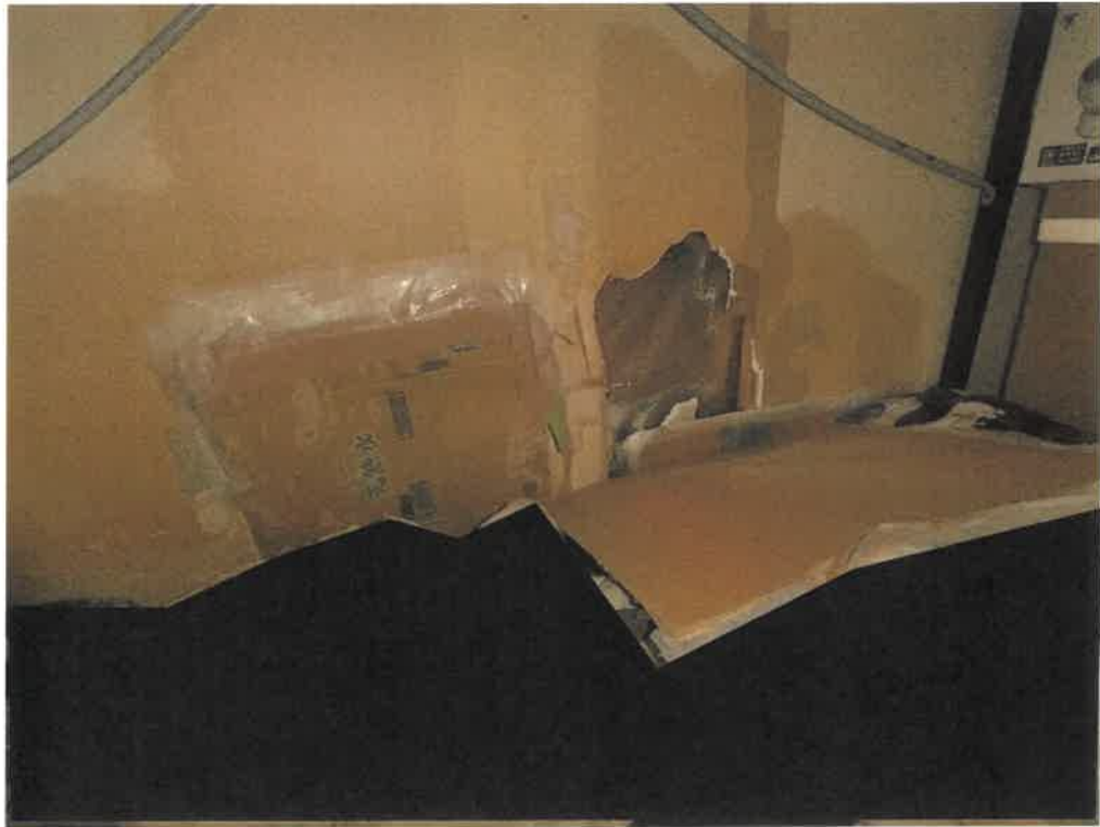
9 物件2建物内部の状況（102号室・洋室・壁面の損傷）
