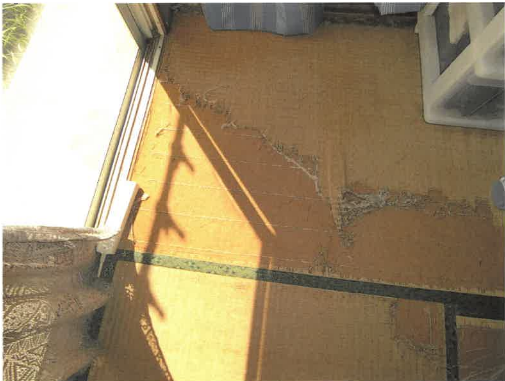
10 物件2建物内部の状況（102号室・和室2・畳の損傷）
