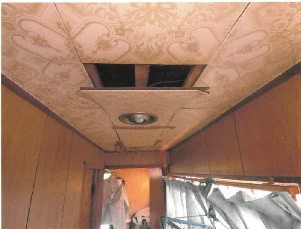
8 物件2附属建物内部の状況（天井の損傷・2階廊下）
