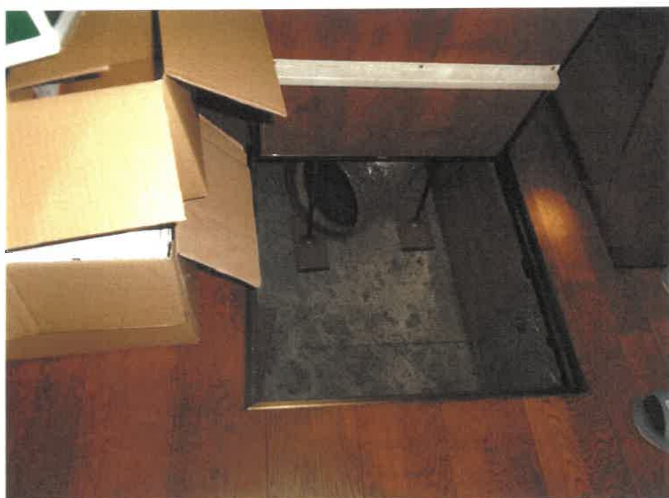
⑩ パイプからの吹出口の状況
