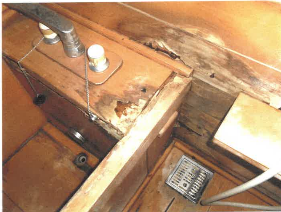
⑧ 檜風呂の浴槽及び壁がシロアリに食われた状況
