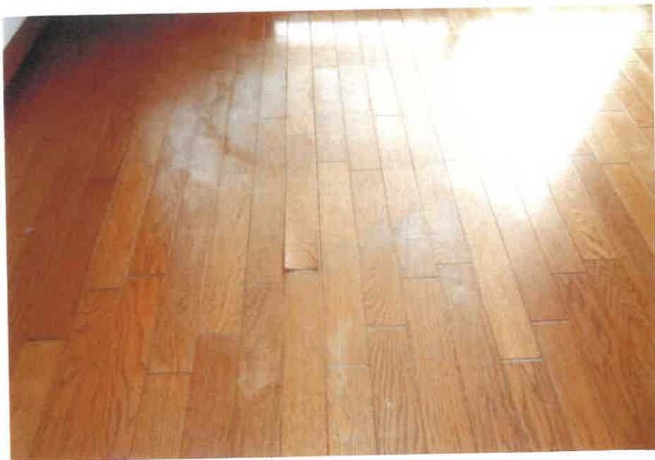
⑧ 屋内の状況（洋室③の床板の剥がれの様子）
