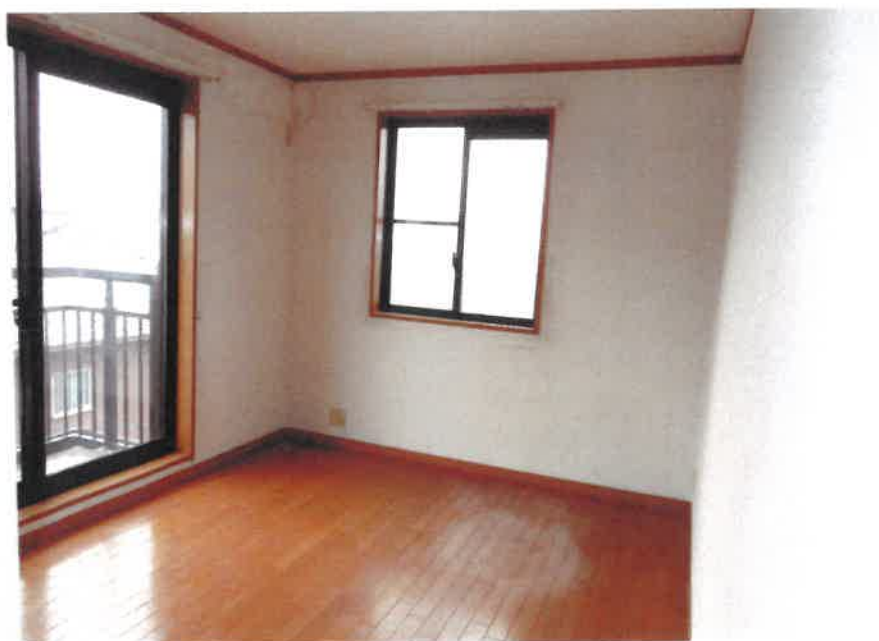
⑥ 屋内の状況（洋室②の床の汚れの様子）
