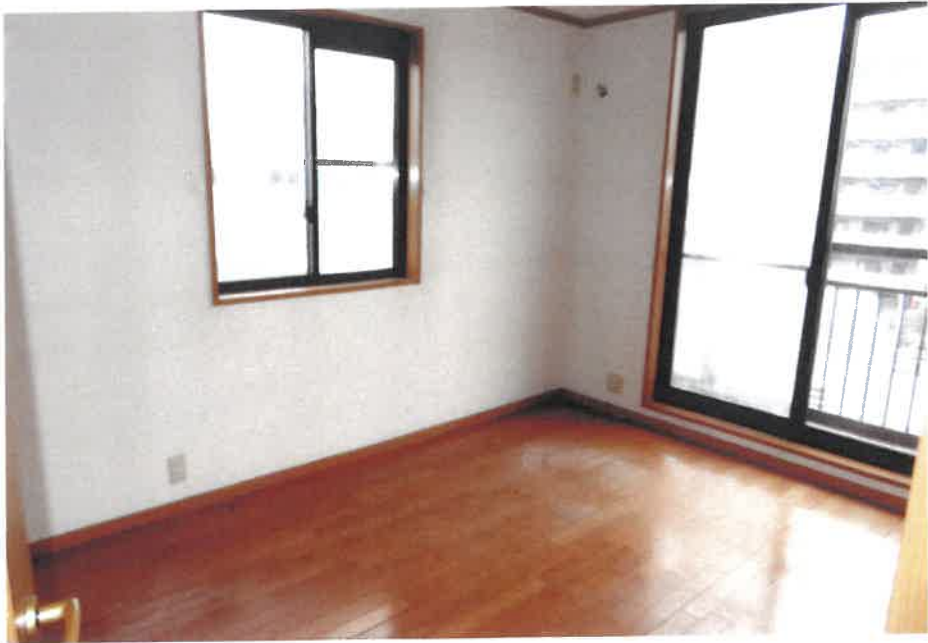
⑦ 屋内の状況（洋室③の床の汚れの様子）
