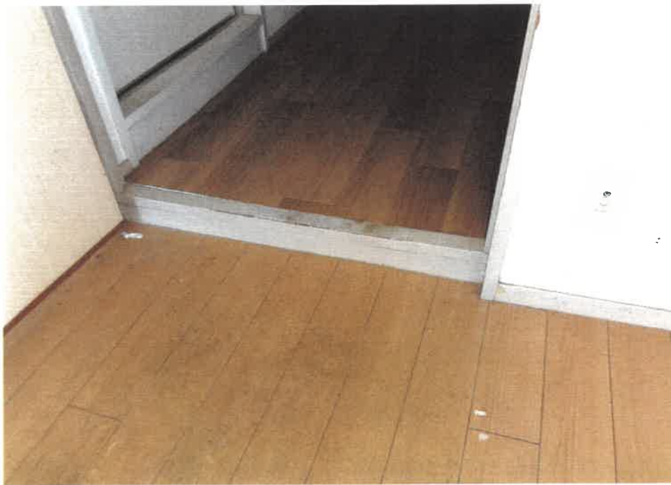
⑥ 洋室とキッチンとの段差
