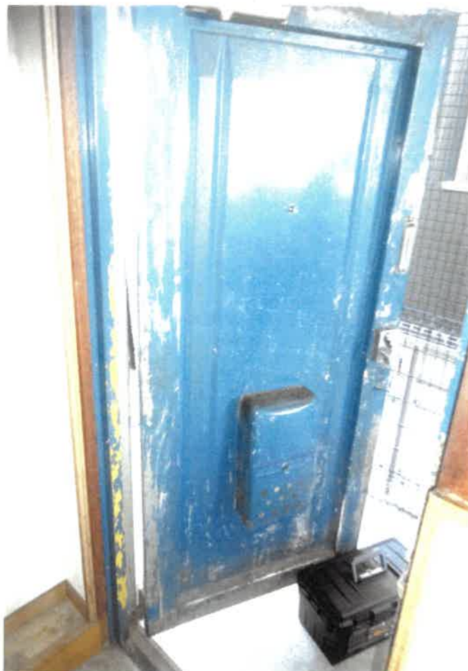
玄関ドアの状況(103号室)
