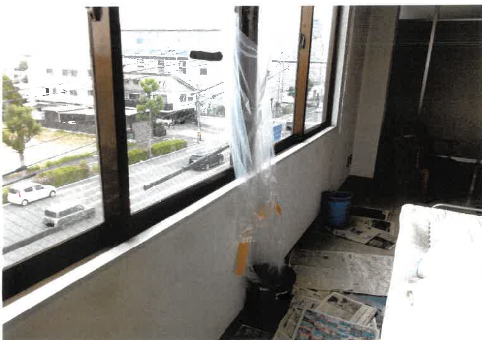
⑥ 事務室 8 雨漏りの状況 1
