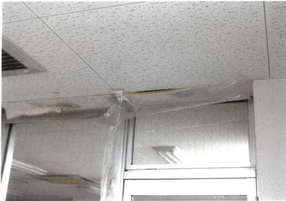
⑦ 事務室 8 雨漏りの状況 2
