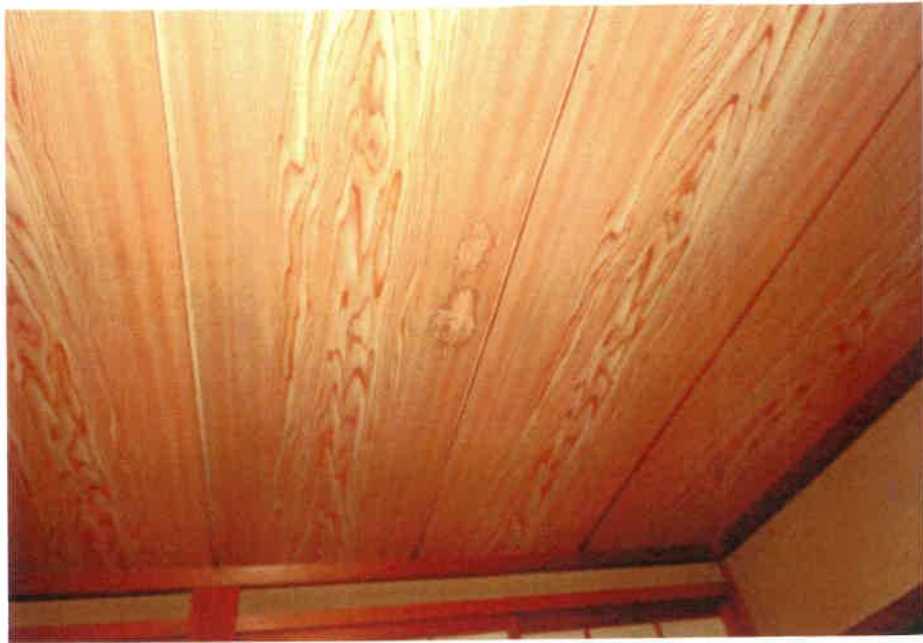
⑦ 屋内の状況（和室2の雨漏り跡の様子）
