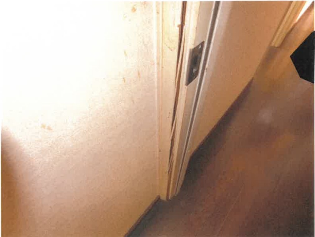
1 2 物件 2 建物内部の状況（ドア枠の損傷（洋室④））
