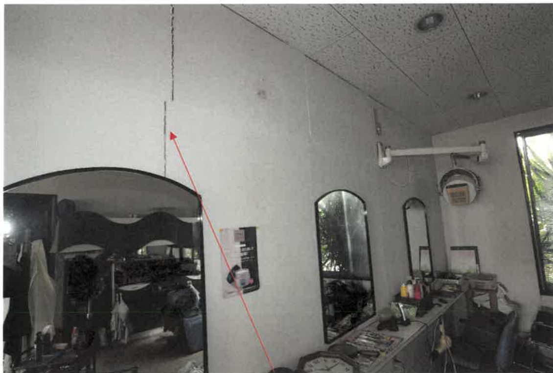
壁紙クロス of 縮み割れ
