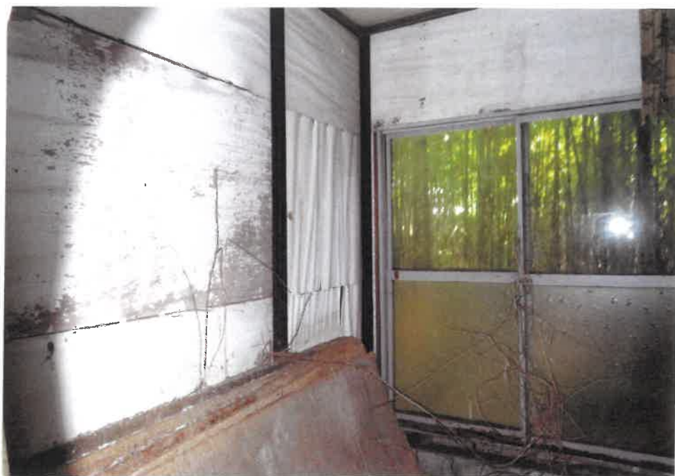
⑬ 屋内の状況（物件 1 4 附属建物符号 2 物置の壁の様子）
