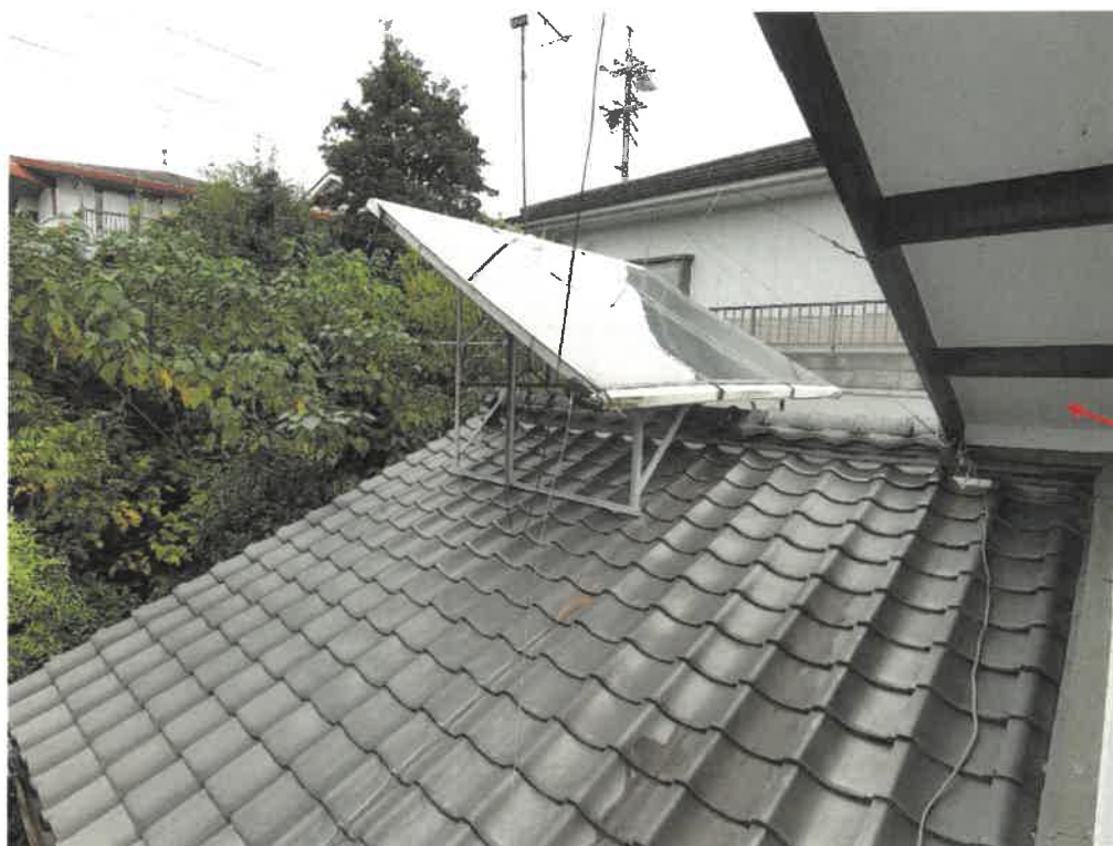
7 物件4建物屋根の太陽熱温水器パネル
