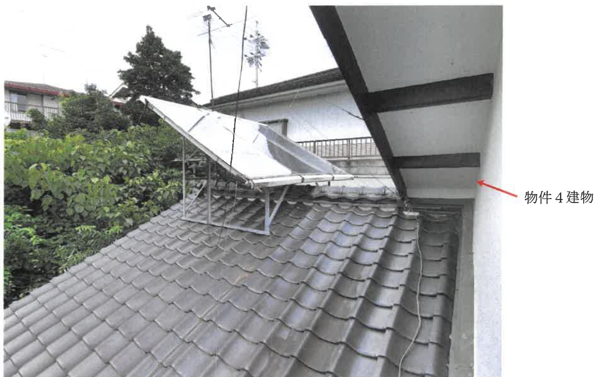
7 物件4建物屋根の太陽熱温水器パネル
