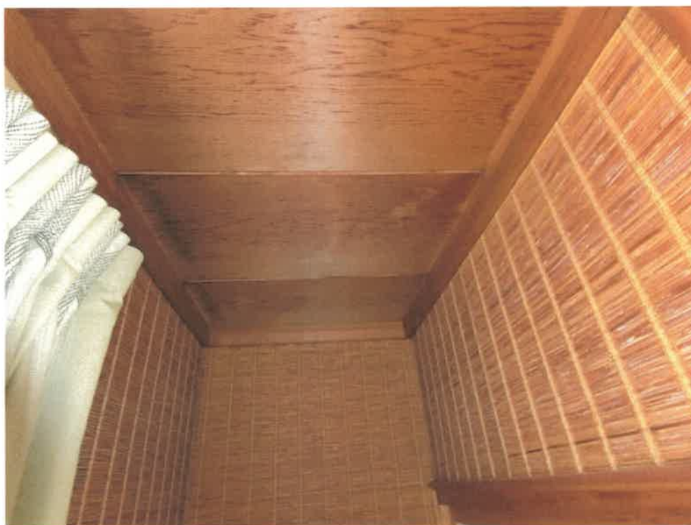
1 2 物件4建物内部の状況（雨漏りによる天井の染み・広縁）
