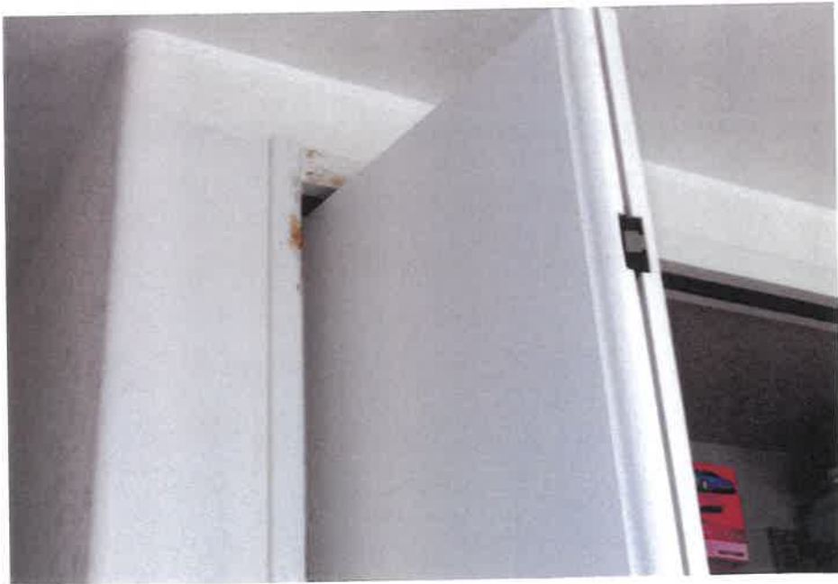
⑧ 屋内の状況（洋室3のクローゼットの木枠の傷の様子）
