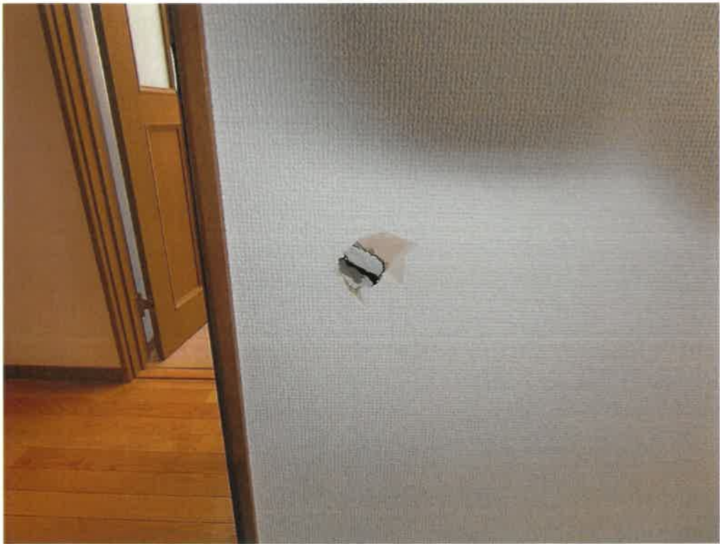
1 2 物件4主である建物内部の状況（壁面の損傷（洋室1））
