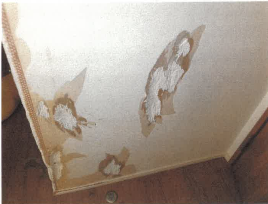
⑧ リビング・ダイニングのクロスの状況 1
