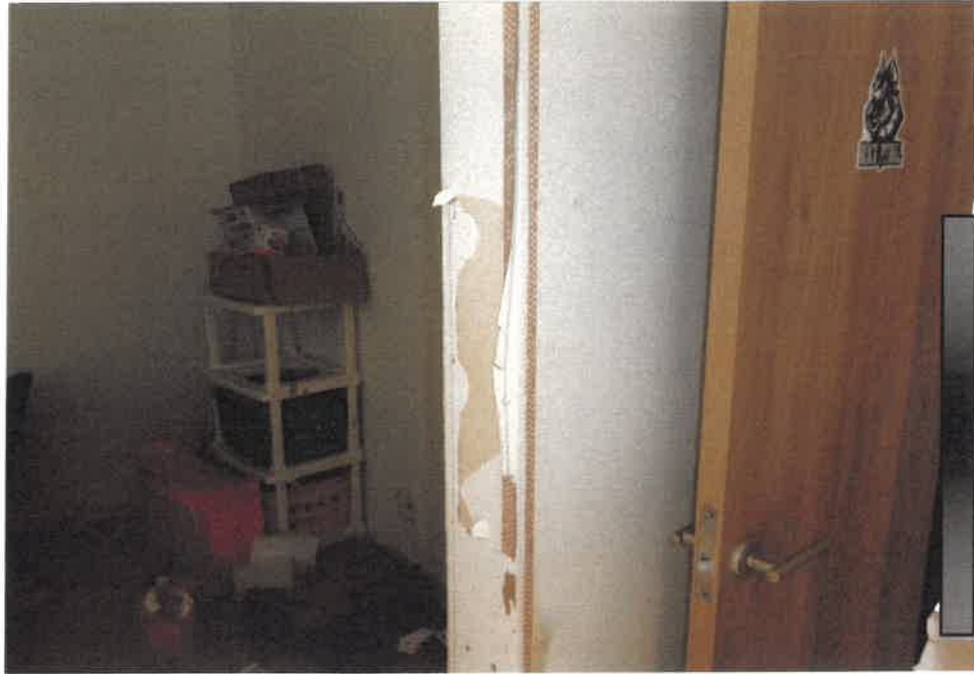
⑨ リビング・ダイニングのクロスの状況 2
