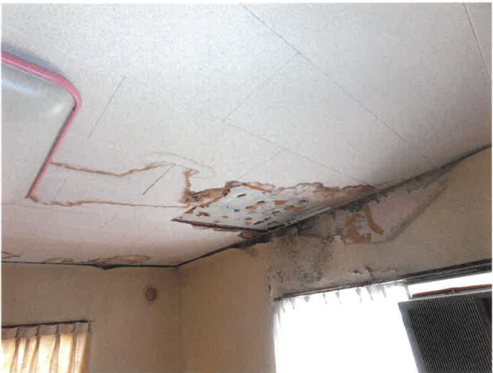
8 物件2建物内部の状況（天井の損傷及び染み（洋室1））
