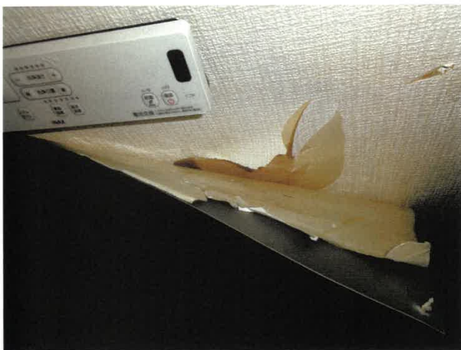
⑧ 1階トイレのクロスの状況
