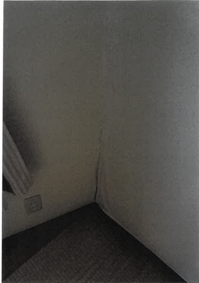
和室 2 の壁のクロス の状況
