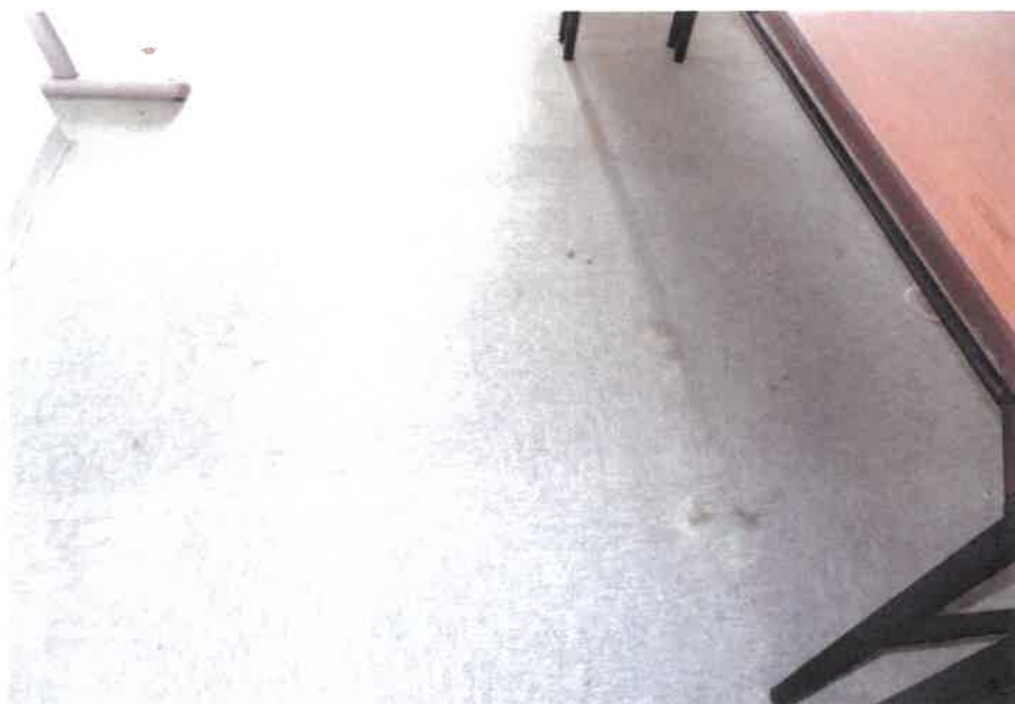
⑥ 屋内の状況（絨毯が傷んでいる様子）
