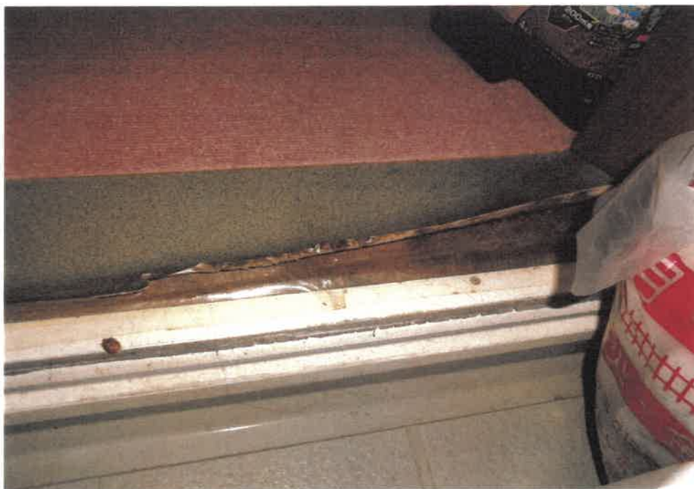
⑥ 浴室入口のシートの状況
