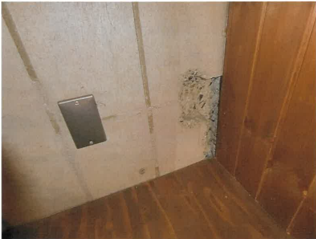
8 物件4建物内部の状況（コンクリート壁面の損傷（居間・食堂））
