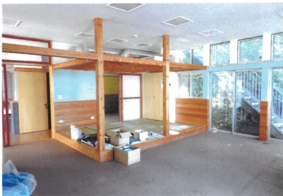
④ 屋内の状況（作業室 1 の畳の様子）
