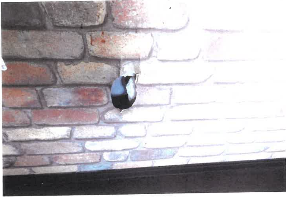
⑤ 屋内の状況（洋室2の壁に穴が開いている様子）
