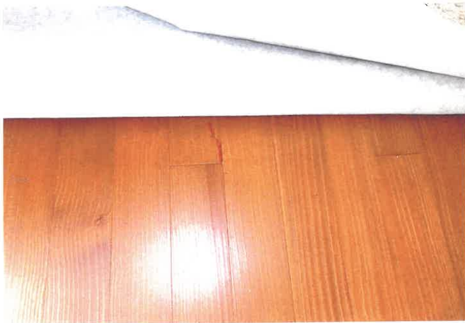
⑨ 屋内の状況（キッチンの床に傷が付いている様子）
