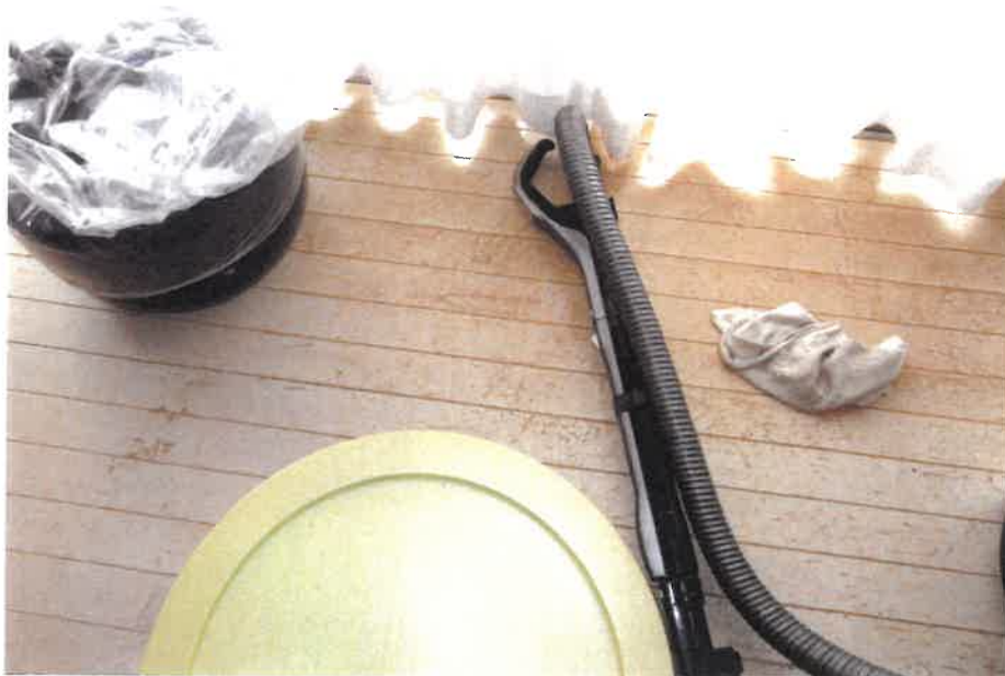
⑫ 屋内の状況（洋室2の床の傷の様子）
