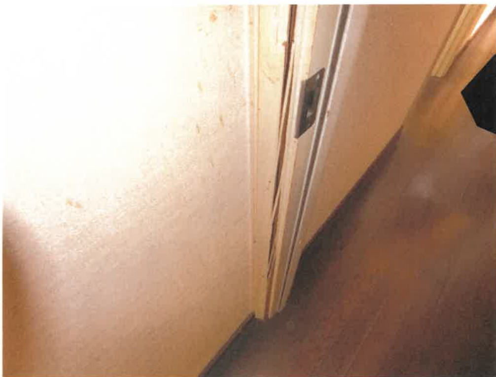
1 2 物件2建物内部の状況（ドア枠の損傷（洋室④））
