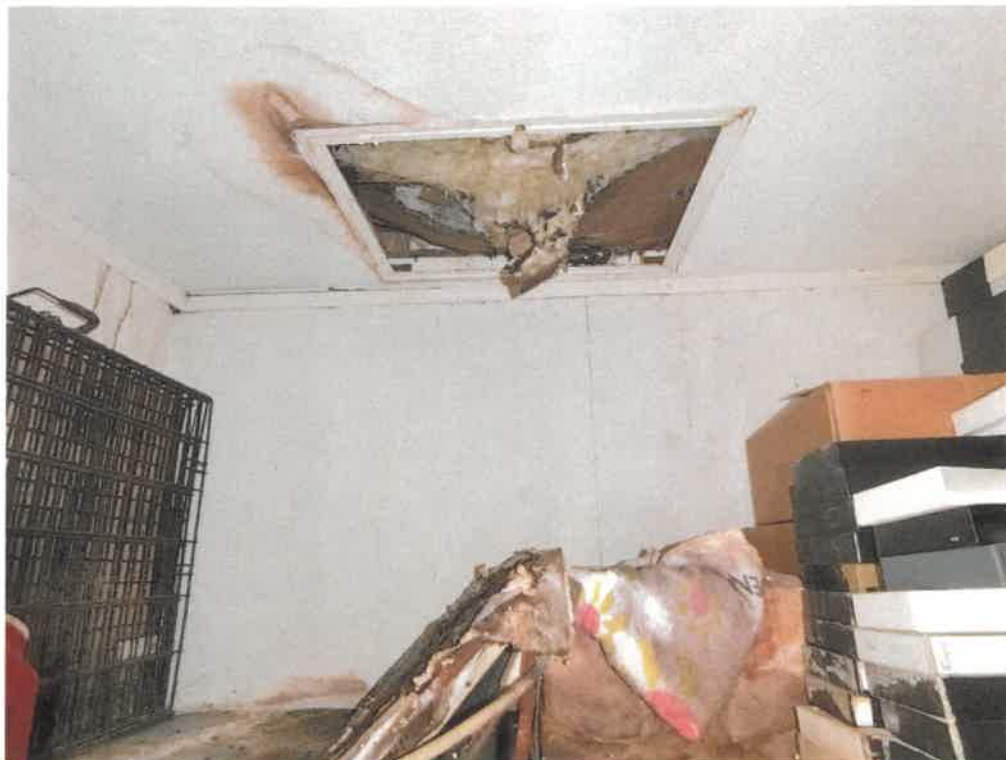
1 1 物件2建物内部の状況（点検口からの水漏れ（入院室②））
