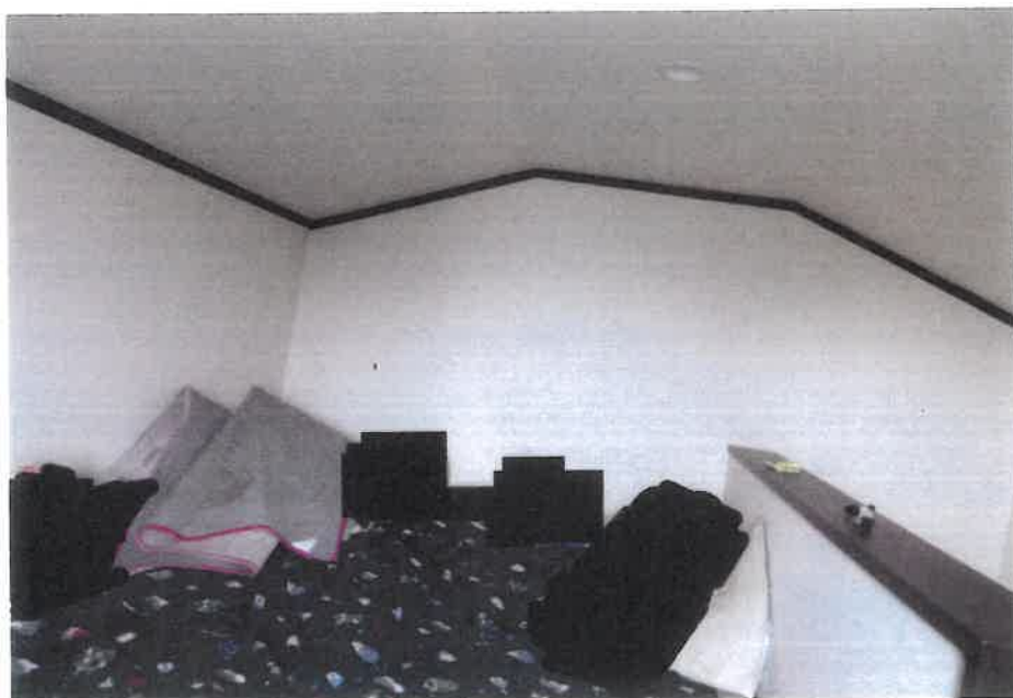
⑤ 屋内の状況（洋室①上部ロフト）
