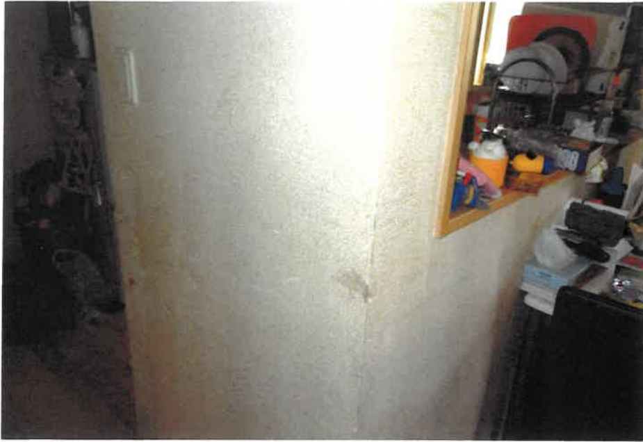
⑨ 屋内の状況（キッチンのクロスが傷んでいる様子）
