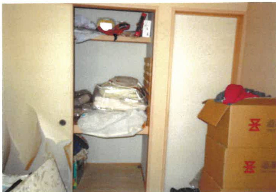
⑧ 屋内の状況（和室の襖が破れている様子）
