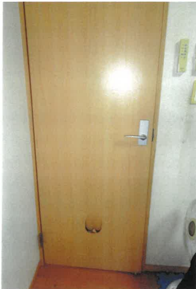
⑩ 屋内の状況（2階洋室1の扉の内側に穴が開いている様子） （〃枚目）
