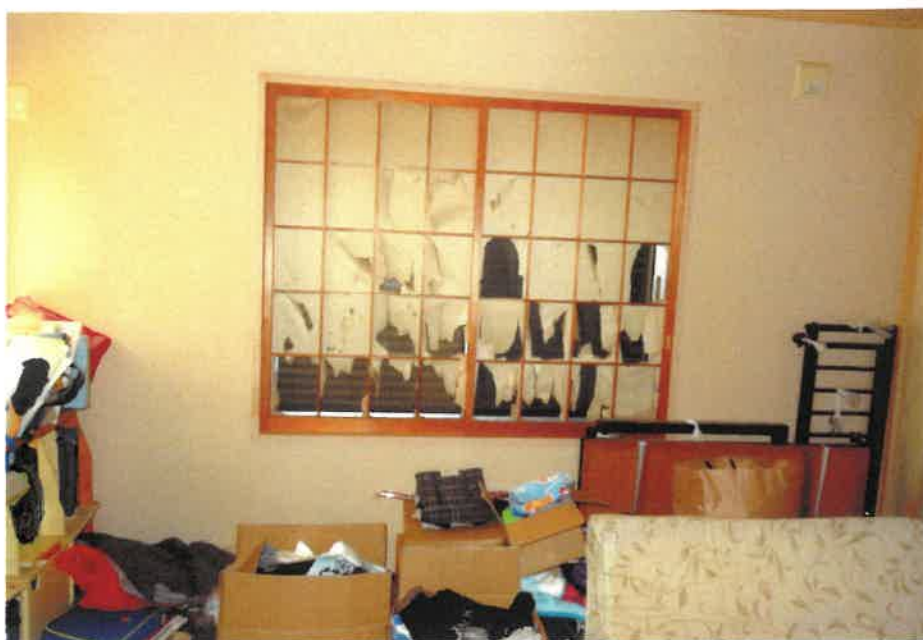
⑦ 屋内の状況（和室の障子が破れている様子）
