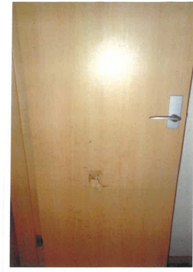
⑪ 屋内の状況（リビング・ダイニングの北西側扉の廊下側に穴が開いている様子）
