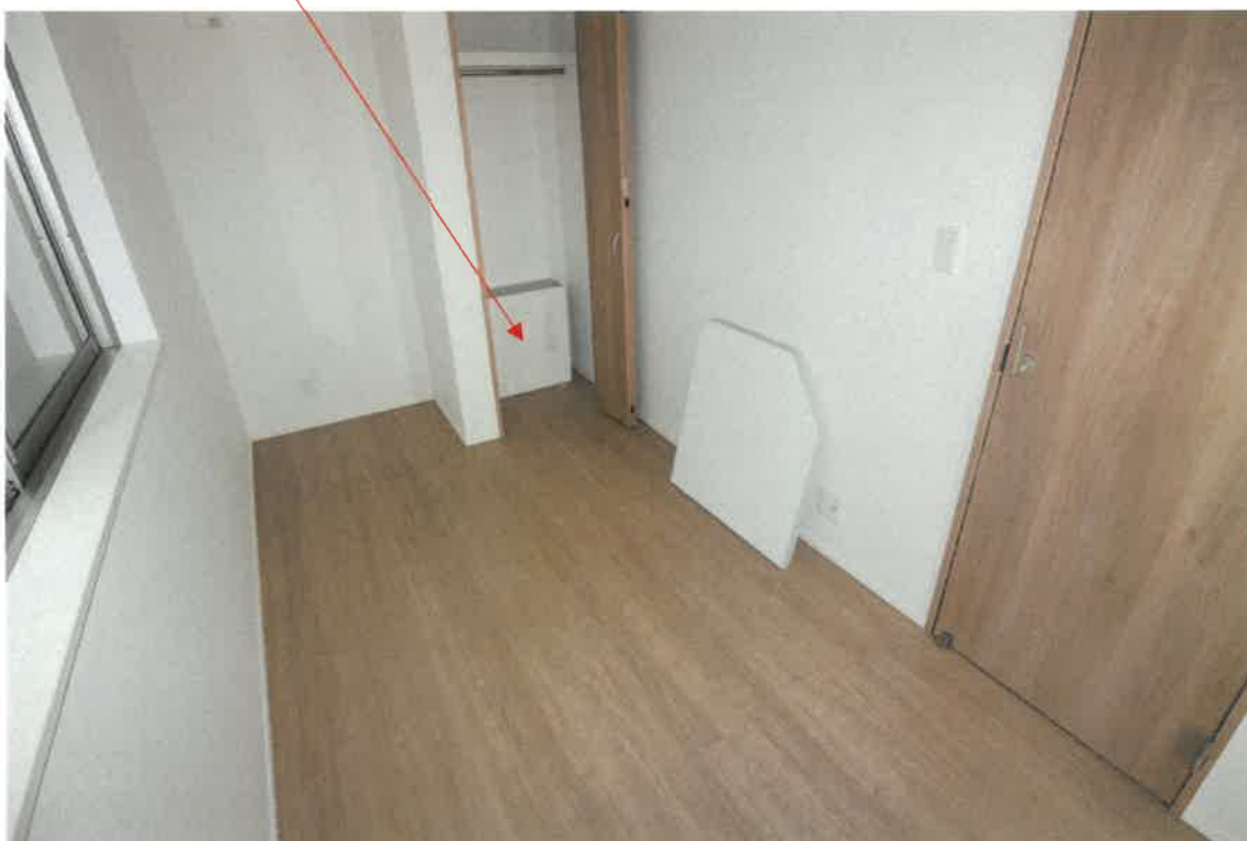
写真2 蓄電池 物件2建物 1階室内(洋室1)
