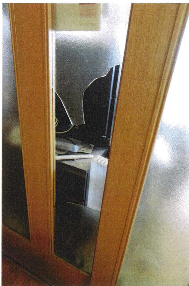
⑧ 扉の損傷状況（洋室3）
