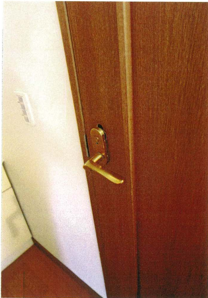
⑧ ドアノブの破損状況 (2階トイレ)
