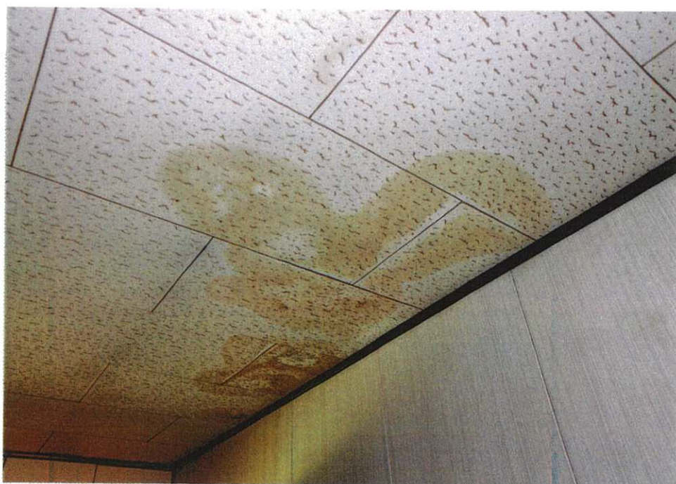
⑩ 雨漏り跡の状況（ダイニング・キッチン）
