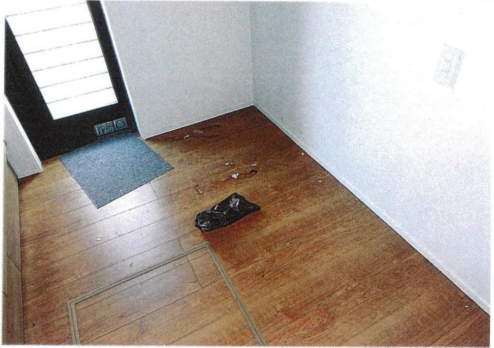
⑦ 床面の汚損状況（キッチン）
