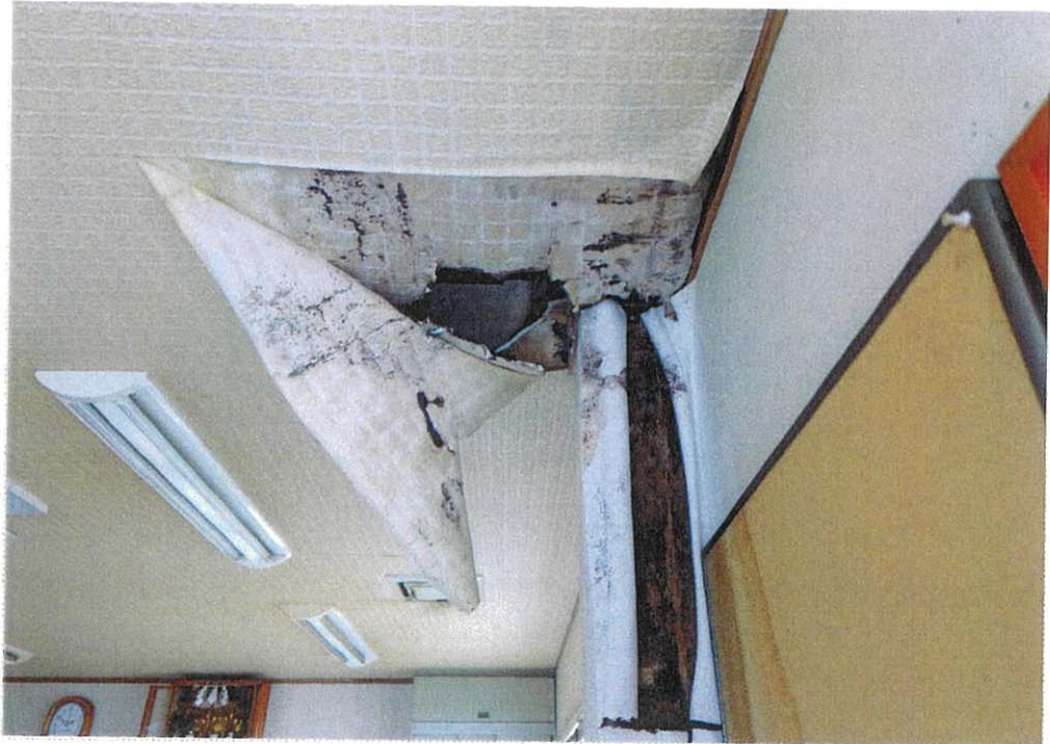
⑦ 雨漏り跡の状況（事務室1（主である建物））
