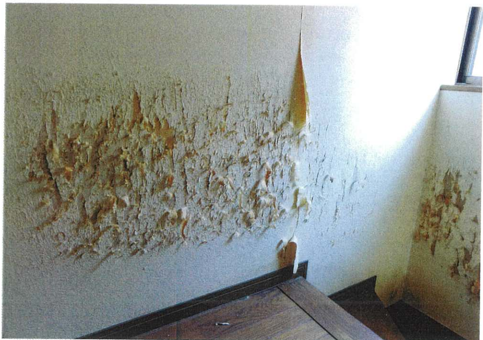
⑧ 壁面の損傷状況（2階階段付近）
