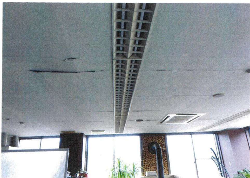
⑪ 天井の破損状況（ホール）
