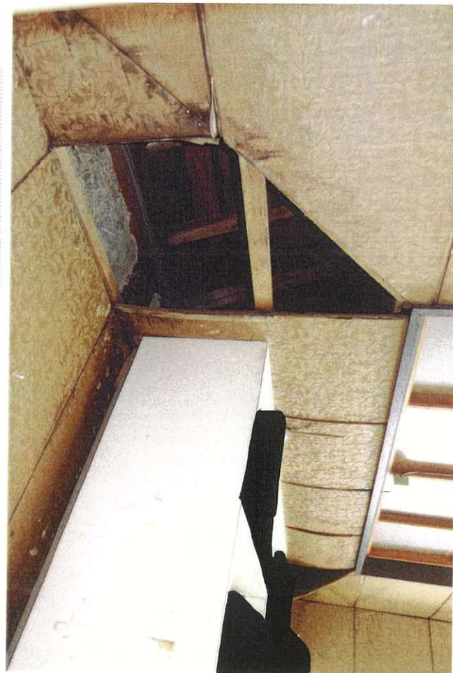
⑩ 天井の破損状況（洋室2（主である建物））
