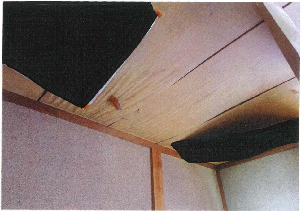
⑦ 雨漏り跡の状況（和室2）
