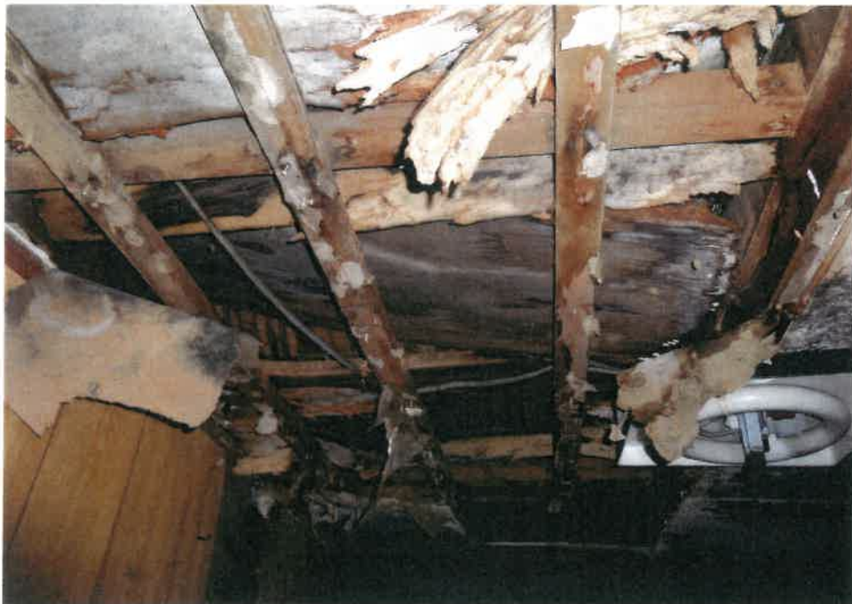
⑫屋内の状況 洗面所の天井 の状況
