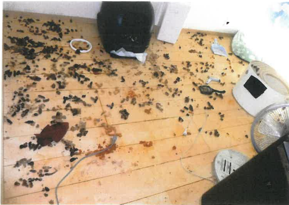
⑤ 屋内の状況 2 階洋室③ の床の状況
